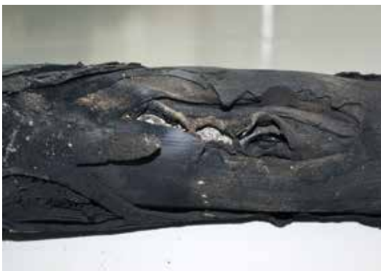
Bild 2. Fehlerstelle eines 20-kV-Muffenfehlers
